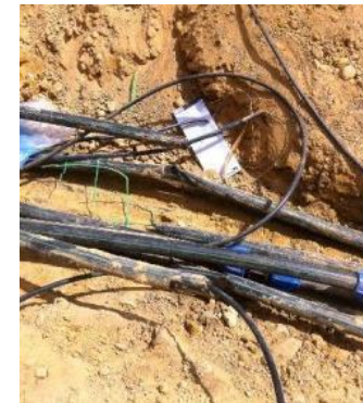
Vélizy 12/5/2011 Rupture de fibres optiques travaux du tramway
